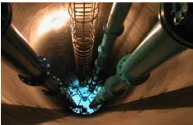
Fig. 7-30: Blick in einen Förderbrunnen, Lockergesteins-Grundwasserleiter (Pumpwerk von Lenzburg in Niederlenz, AG).
