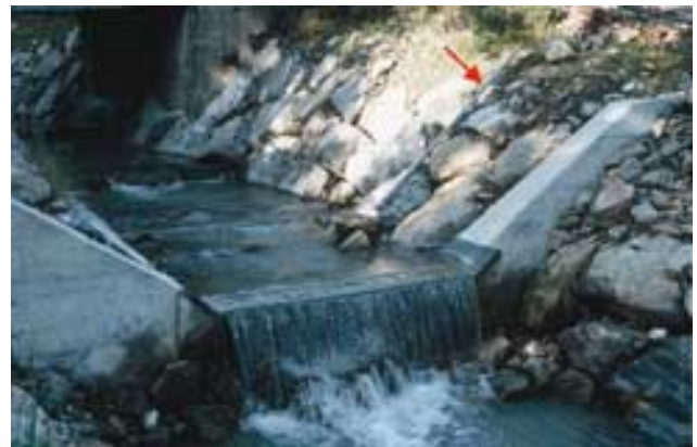
Fig. 5-17: Messstation Bütschlibach – Bumbach (BE) Messung Wasserstand Hochwassergrenzwertpegel Messung Abfluss Hydraulische Berechnung
