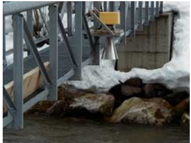
Fig. 5-5: Pegelmessung mit Pulsradar, Alp – Einsiedeln (SZ).
